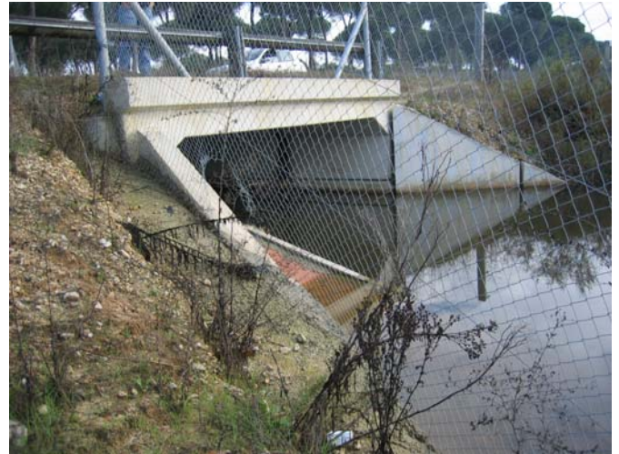
Paso de fauna inundado en el Camino Agrícola
